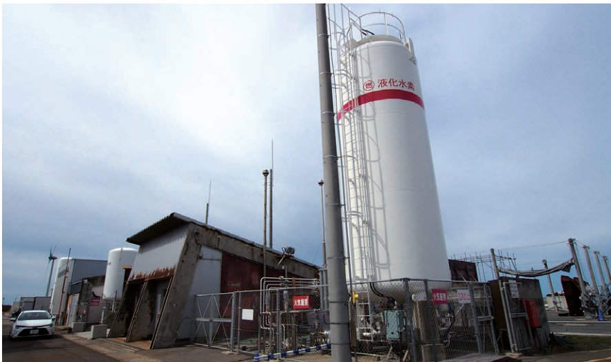
JAXA能代ロケット実験場に設置された液化水素タンク。液体水素はロケットの燃料に使われており、実験場で燃焼実験などが行われている
